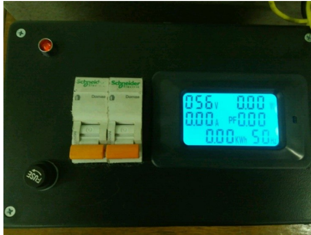
Gambar 11. Tegangan fasa netral dari generator satu
