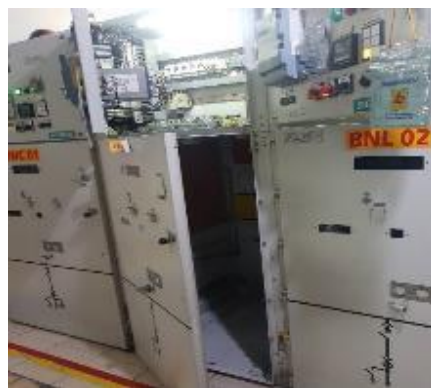
Gambar 2. Kubikel 20 KV Gardu Induk Bantul
