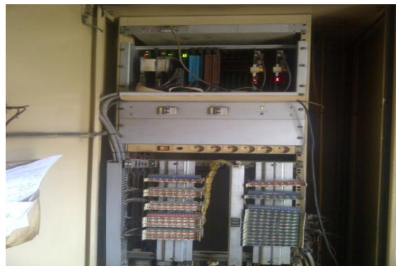
Gambar 13. RTU dengan Media Komunikasi Kabel Kontrol atau Radio
