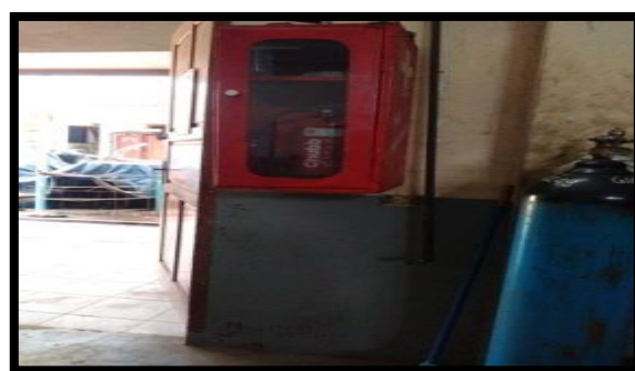
Gambar 3.5 Kondisi eksisting APAR Laboratorium Teknik Mesin
